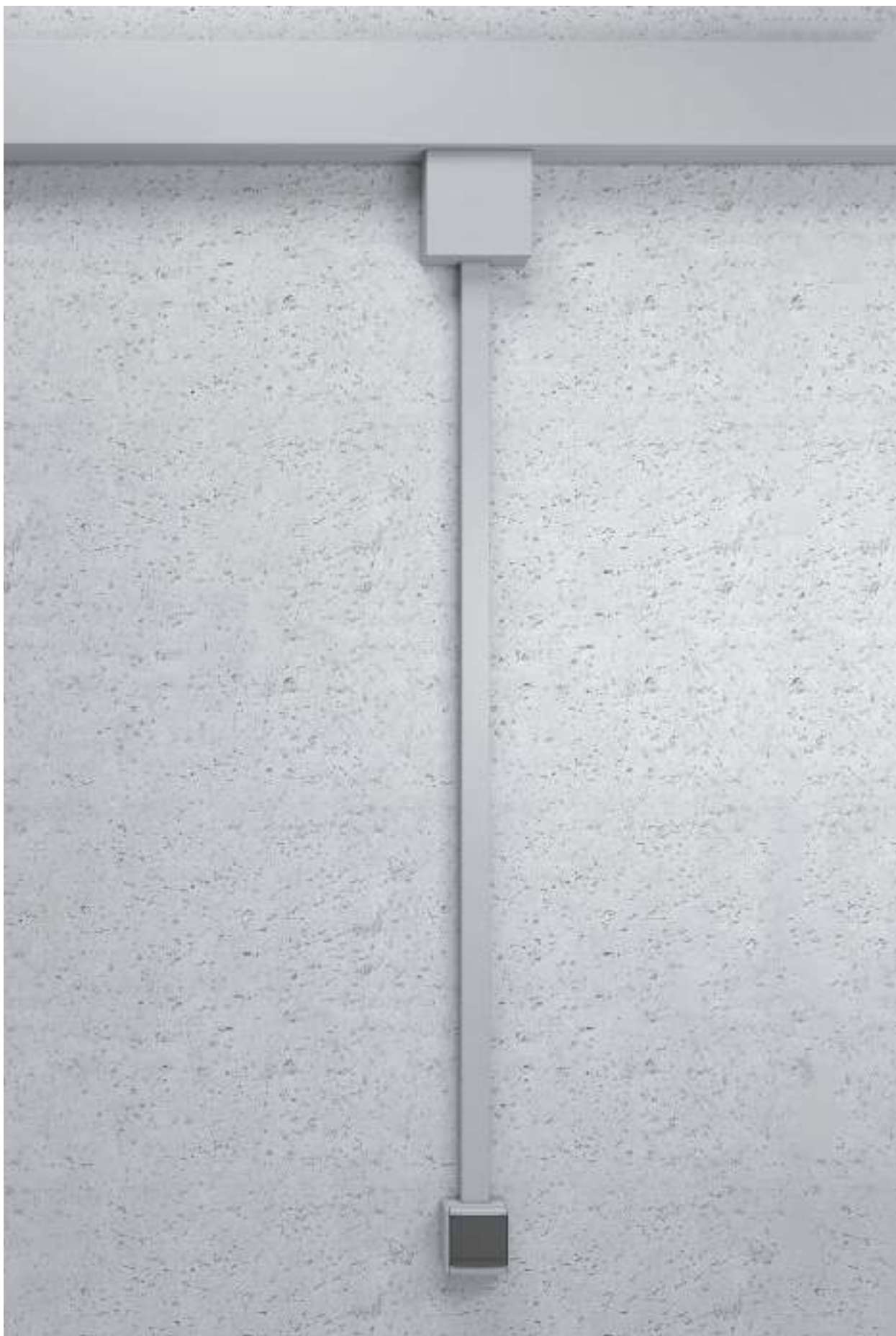
Nave industrial: alimentación de mecanismos
