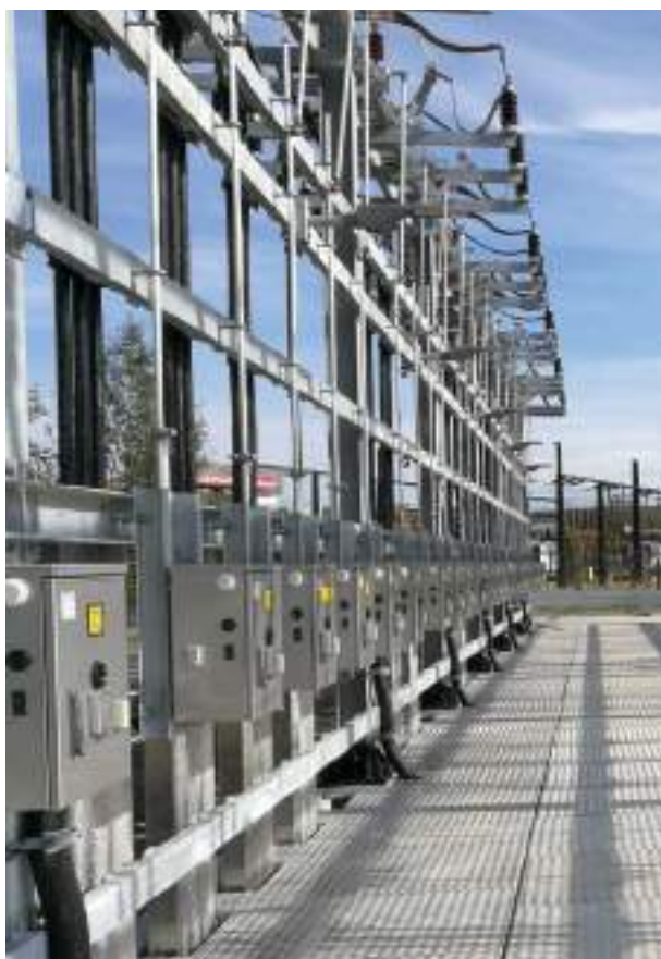
Producción y distribución de energía eléctrica
