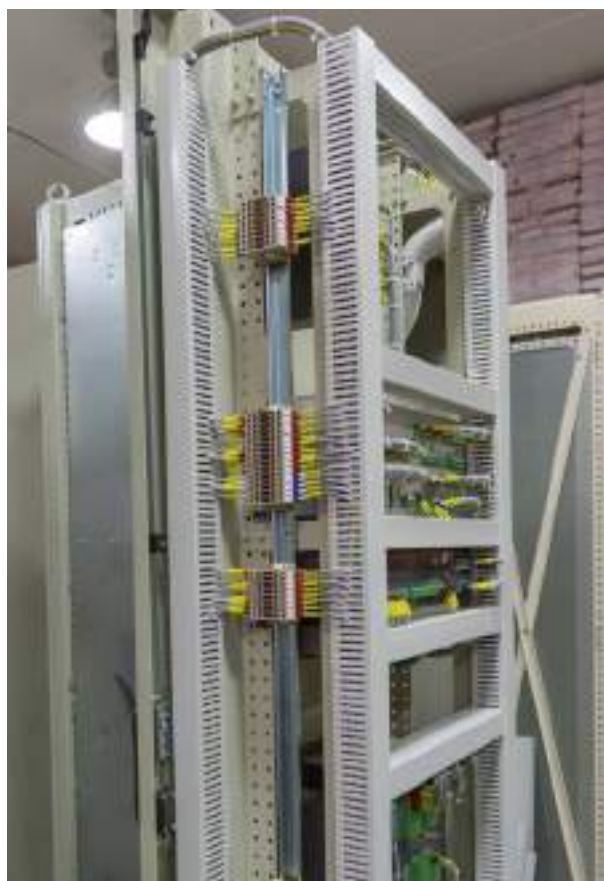
Producción y distribución de energía eléctrica
