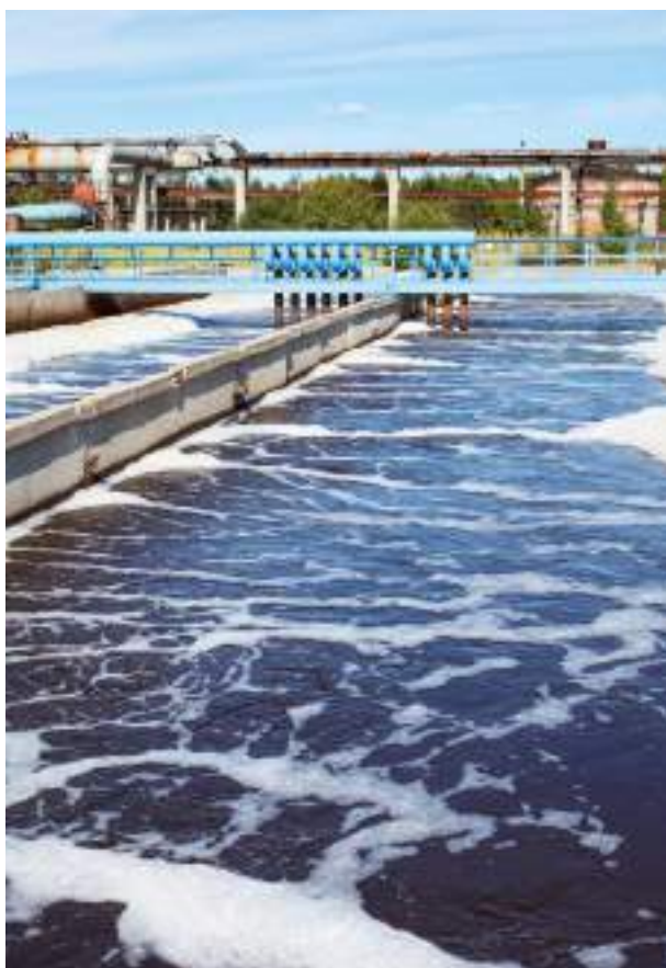
Tratamiento de aguas: EDAR
