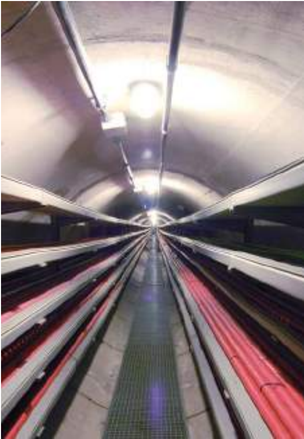
Aeropuerto: galería técnica
