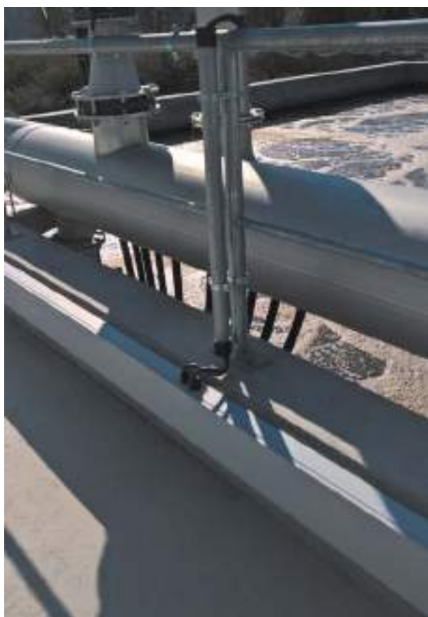
Tratamiento de aguas: EDAR
