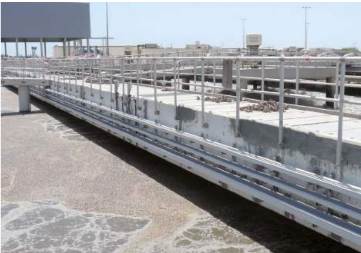
Tratamiento de aguas: EDAR
