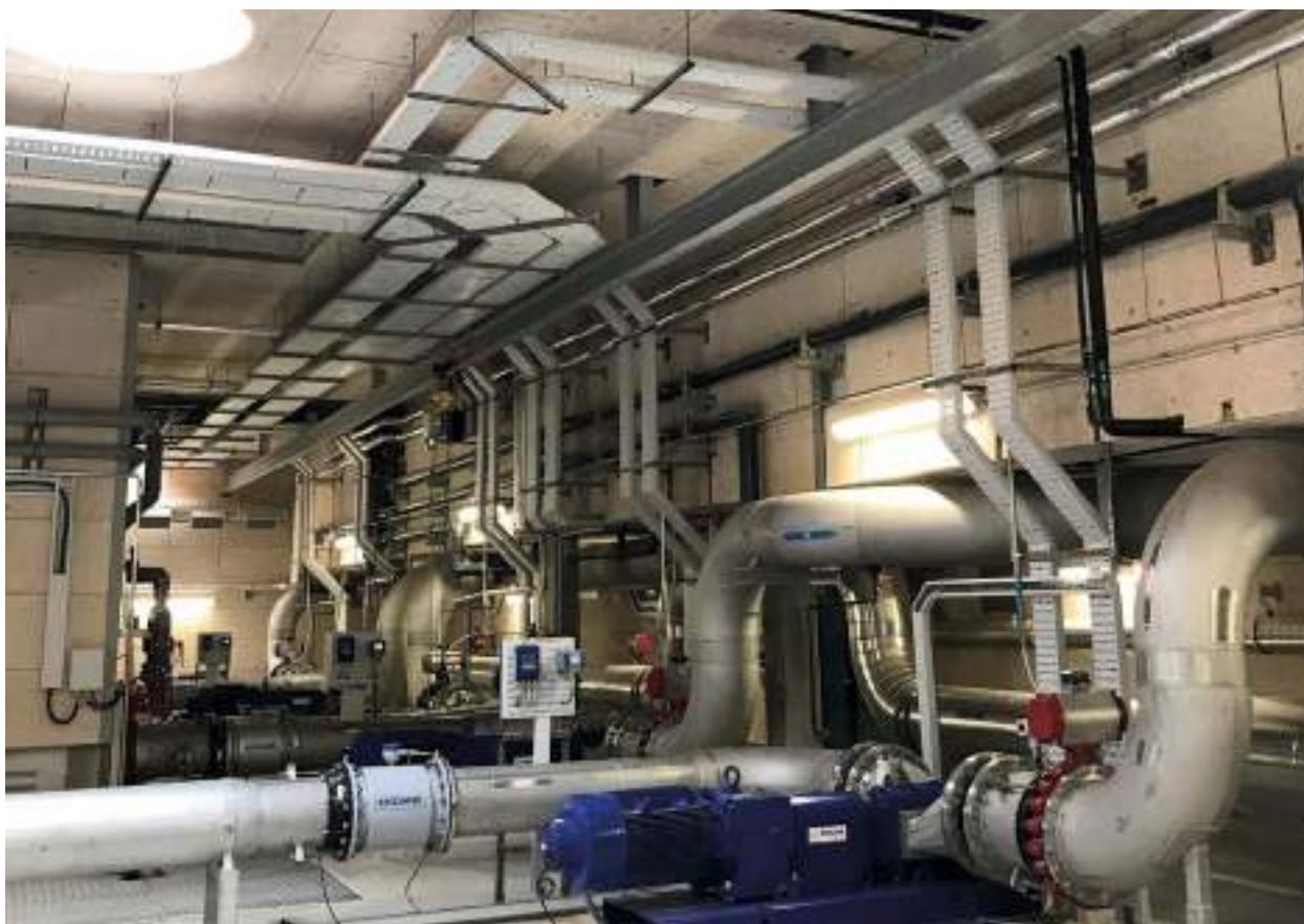
Tratamiento de aguas: EDAR
