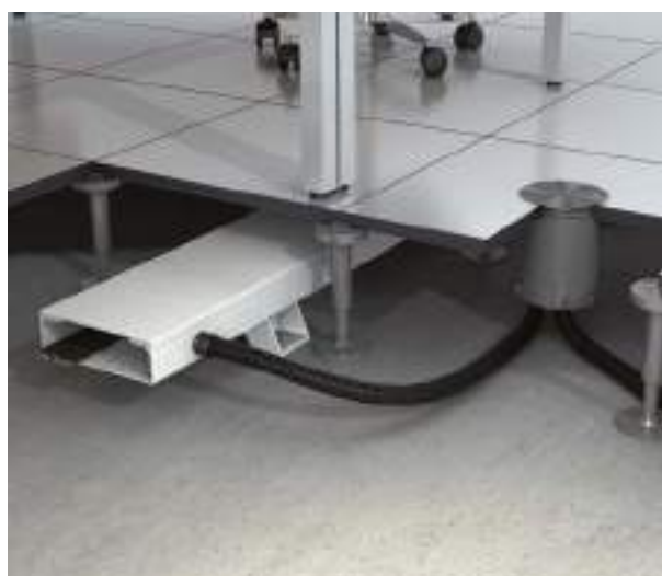
Alimentación por suelo técnico
