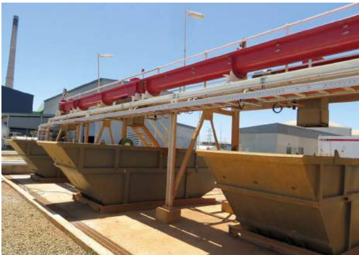
Tratamiento de aguas: desalinizadora
